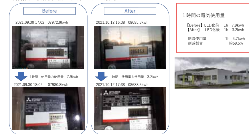
S市保育園 電気使用量調査（屋外メーターで計測）
